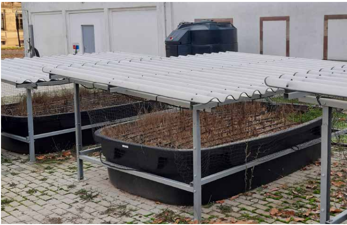
Phytobac: Das Waschwasser wird über bepflanzte Behälter verrieselt
